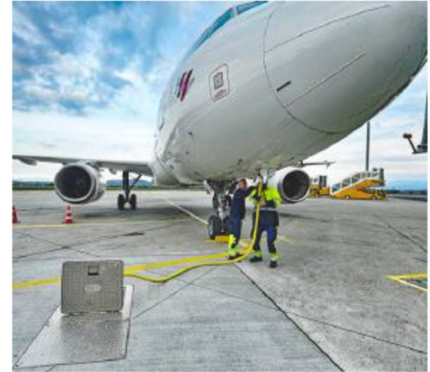
Anstecken eines Flugzeugs an die neue Bodenstromversorgung.
