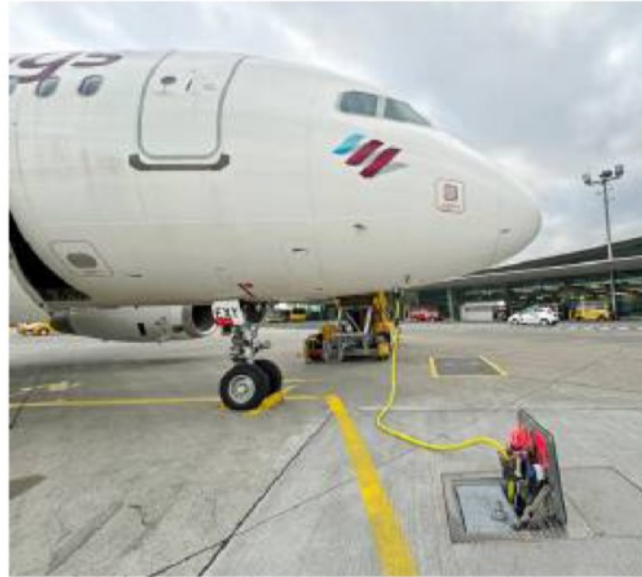
Blick auf das angesteckte Flugzeug und die Stromversorgung Graz Airport (2)
